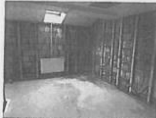
Pomieszczenia piwnic - widoczne zawilgocenia
