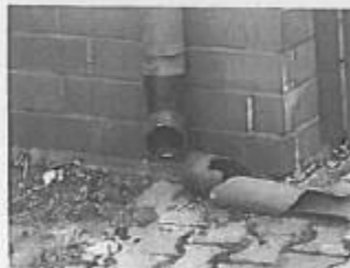
Uszkodzona rura spustowa w okolicach wejścia do budynku
