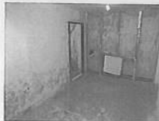
Pomieszczenia piwnic - widoczne zawilgocenia
