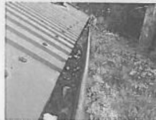
Zaleca się konserwację rynien zadaszera nad częścią piwniczną od strony budynku przy ul. Radzikowskiego 54
