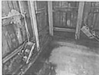
Zawilgoceń w pomieszczeniu piwnicy od strony sąsiadującego budynku przy ul. Zygmuntowskiej
