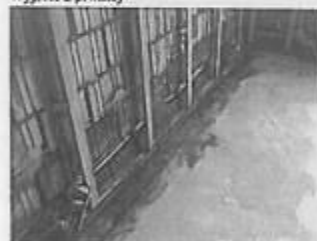
Zawilgoceń w pomieszczeniu piwnicy od strony sąsiadującego budynku przy ul. Zygmuntowskiej
