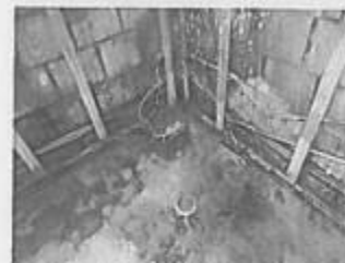
Pomieszczenia piwnic - widoczne zawilgocenia
