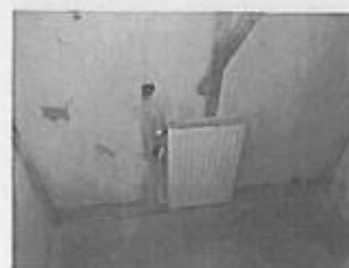
Pomieszczenia piwnic - widoczne zawilgocenia
