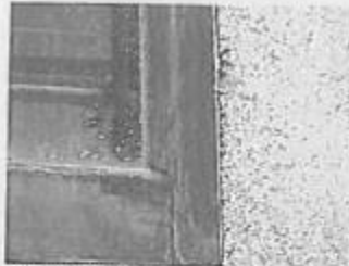
Szalarka okna drewniana – zalecna konserwacja
