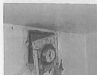
Uszkodzona wentylacja w pomieszczeniu piwnicy
