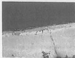
Zapadnięcie opaski betonowej
