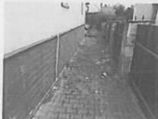
Zaleca się uporządkowanie opaski chodnikowej od strony budynku przy ul. Radzikowskiego 54
